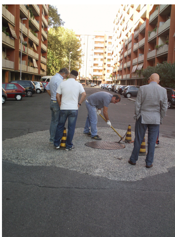
Pozzetto n.1 incrocio Via Calosso – Via Ruini
